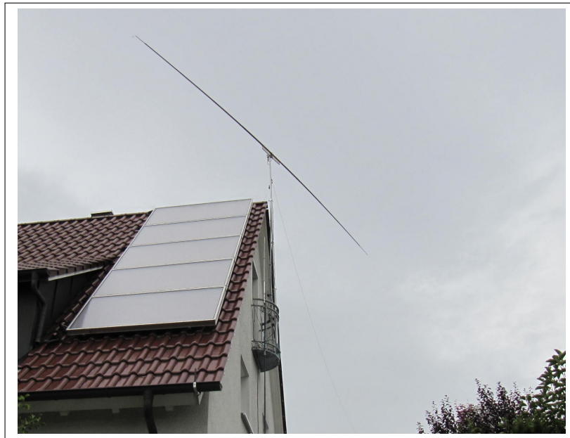
Ein drehbarer 4-Band-Dipol über dem Dach
